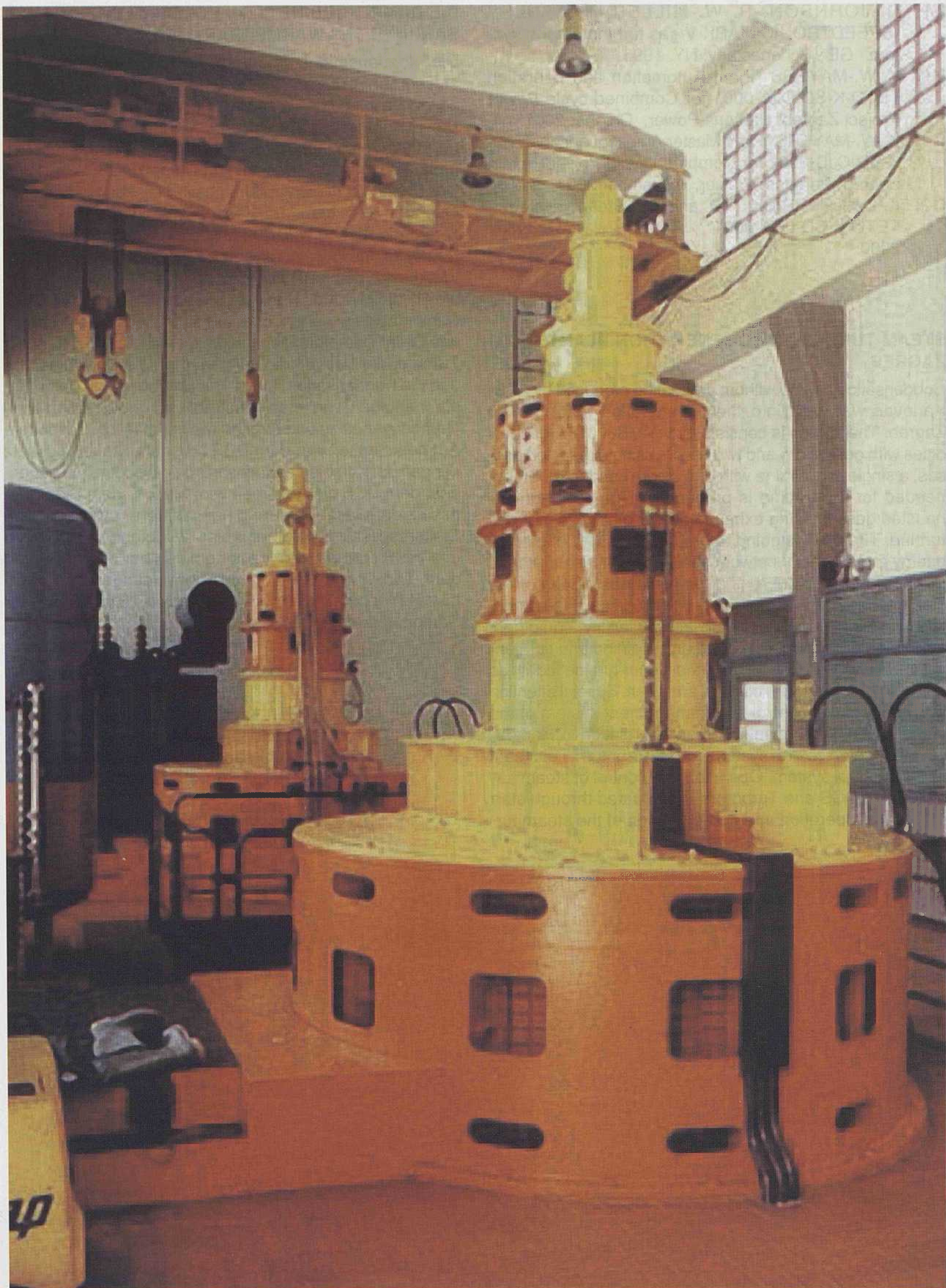
Unutrašnjost strojarnice HE Ozalj II
